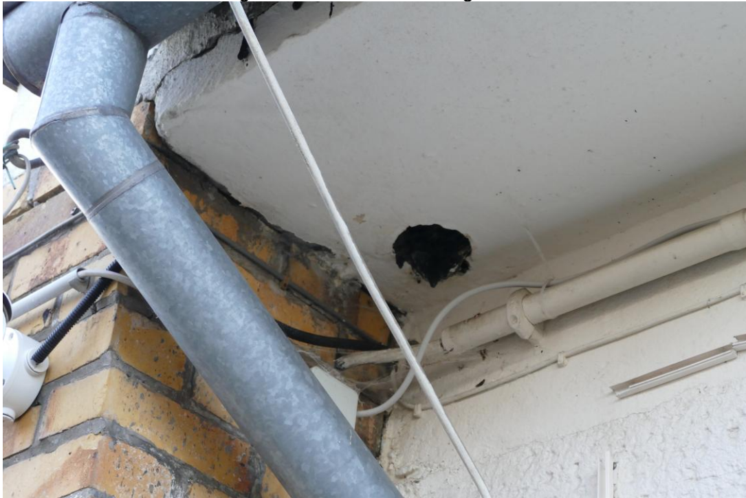
Bild 05: Loch vom ehemaligen Abflussrohr am Bürogebäude
